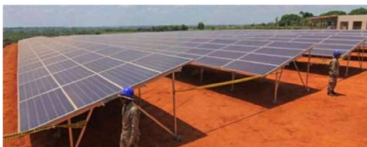
Ilustración 19 - Imagen de un Panel Fotovoltaico (Lic. Vera, 2018)
